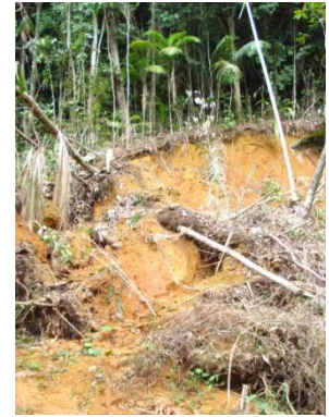
Figura 3: Detalhe do trecho da trilha onde ocorreu o escorregamento de terra da margem.
